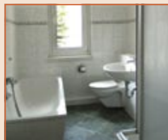
Bad mit Dusche und Wanne
