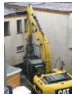
Der Abriss des ungenutzten Nebengebäudes schafft Platz für PKW-Stellplätze und Grünflächen im Hof.
